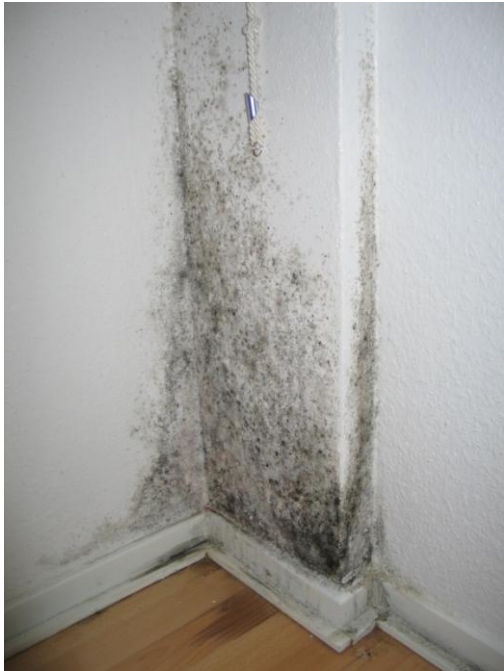
Schimmelbefall auf einer Wand
